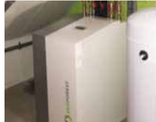
Binnendeel warmtepomp in plaats van CV
